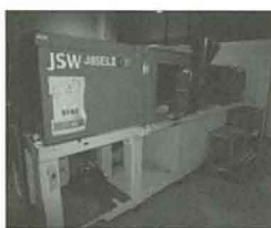
成形機（日本製鋼所J85EL II、他6台）
