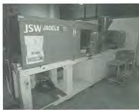
成形機（日本製鋼所J85EL II、他6台）
